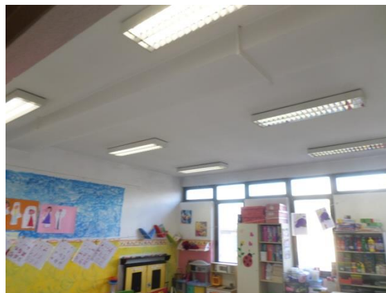
Figura 4.11 - Particolare dei corpi illuminanti ubicati nelle aule
