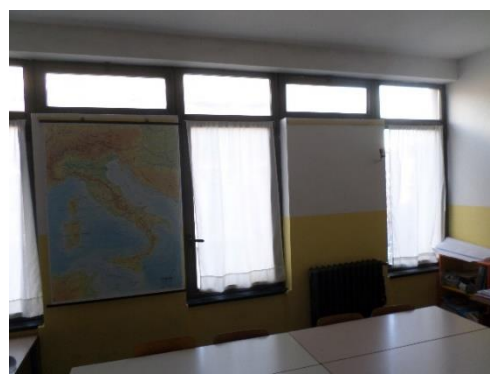
Figura 7.8 – Particolare radiatori attuali
