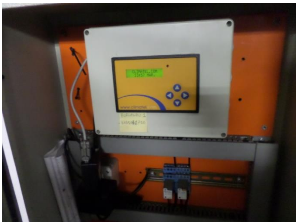
Figura 4.7 - Particolare della centralina di controllo
